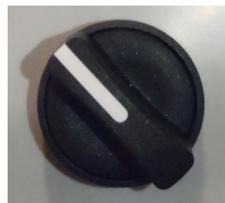
Conmutador en posición CONTROL REMOTO
